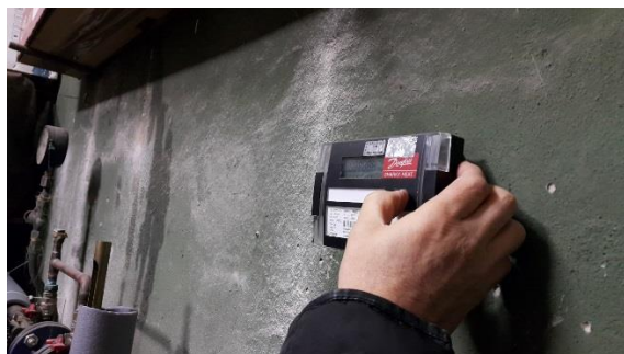
Piebūvē esošais siltummezgls ar siltumenerģijas skaitītāju
