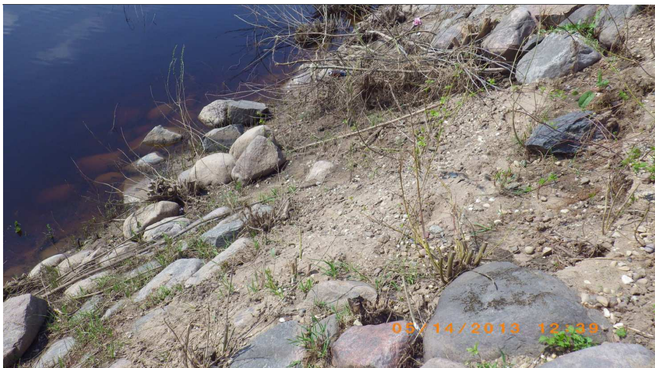
3. att. Lokāli bojāta dambja nogāzes nostiprinājuma konstrukcijā
