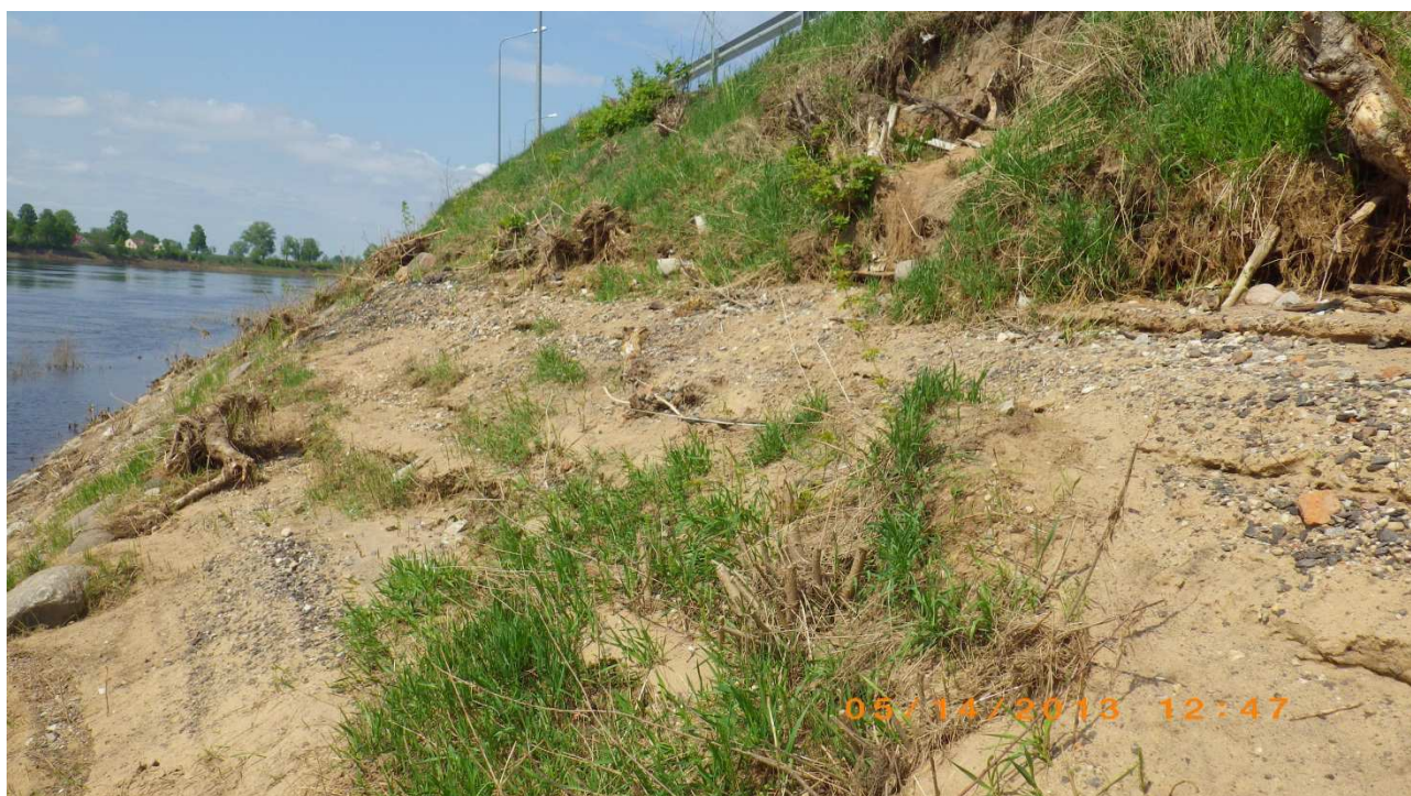
4. att. Plašākā dambja posmā bojāta nogāzes nostiprinājuma konstrukcija
