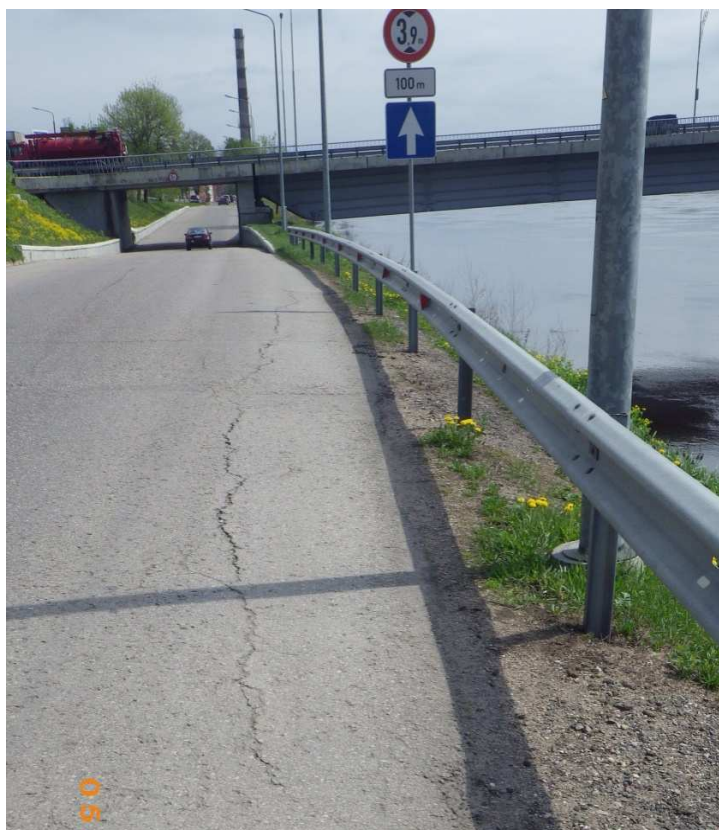
1. att. Garenplaisa asfaltbetona segumā, kas norāda, ka nelielā apjomā, bet notiek ceļa nomales deformācijas
