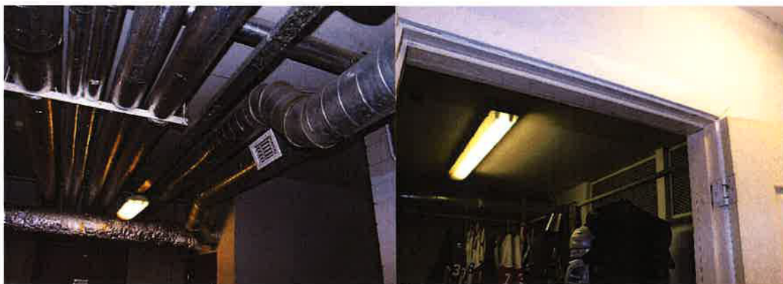
Ventilācija telpa zem tribīnes bez rekuperācijas
