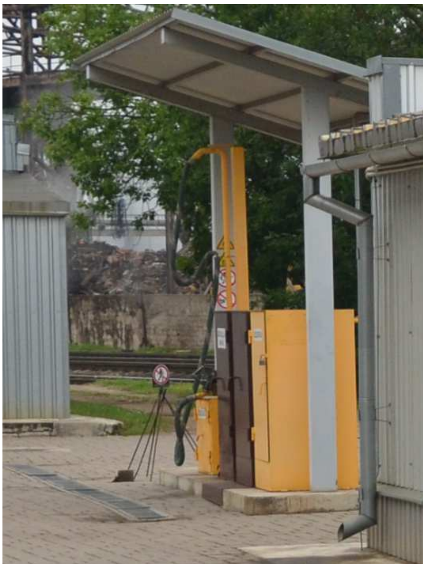
2.6. attēls. Autotransporta uzpildes punkts
