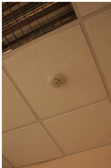
Att. 6.4. Ugunsdrošības signalizācijas devējs administrācijas ēkā
