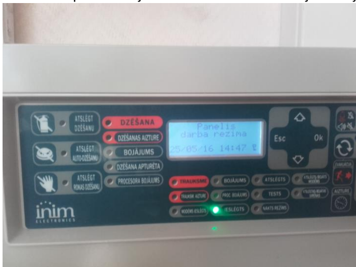
Att. 6.7. ugunsdrošības signalizācijas panelis PSLINE 2004 SmartLine 020-4
