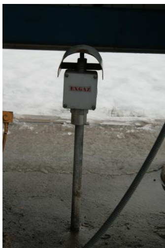
Att. 6.1. Gāzes noplūdes signalizācijas devējs (stacionārais gāzes analizators)
