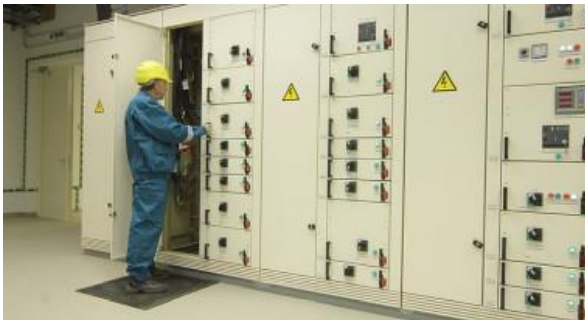
LRDS "Ilūkste" elektrosadales telpa
